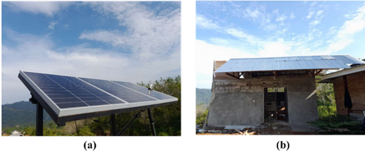
Gambar 4. Hasil Perancangan PLTS off-grid (a) Solar panel yang telah dipasang (b) Ruang untuk menyimpan inverter dan panel box
