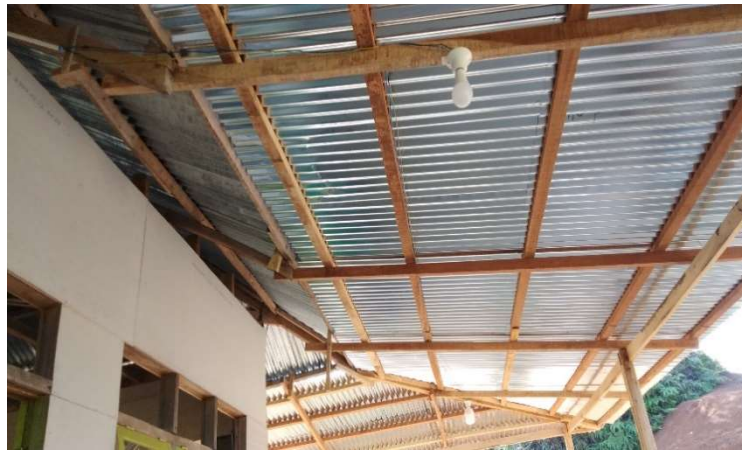
Gambar 1. Instalasi listrik yang tidak sesuai standar PUIL.
