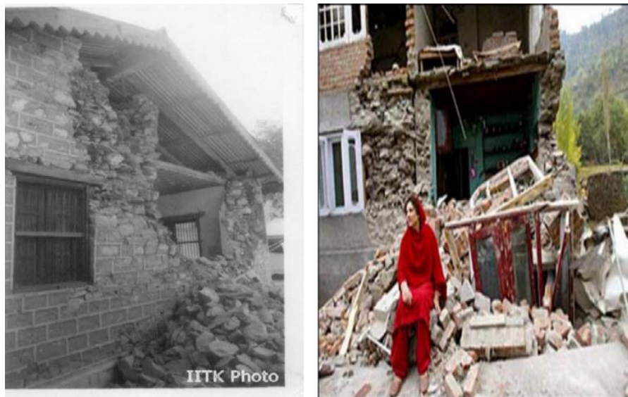
Gambar 1. Kegagalan pada rumah pasangan batu bata
