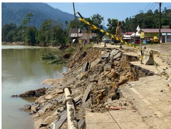
Gambar 1. Longsor pada lereng di ruas jalan KM.45+400
