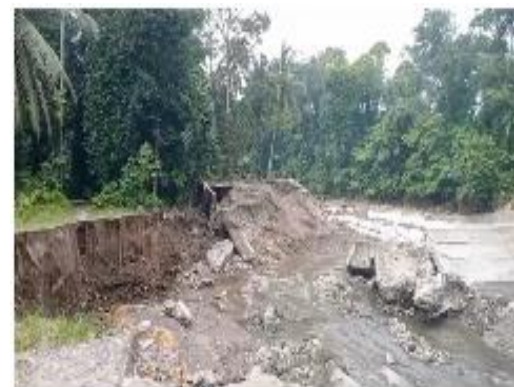
Gambar 3. Kondisi Tebing Sungai Di Hulu Bendung Ladang Laweh Sungai Batang Mangor
